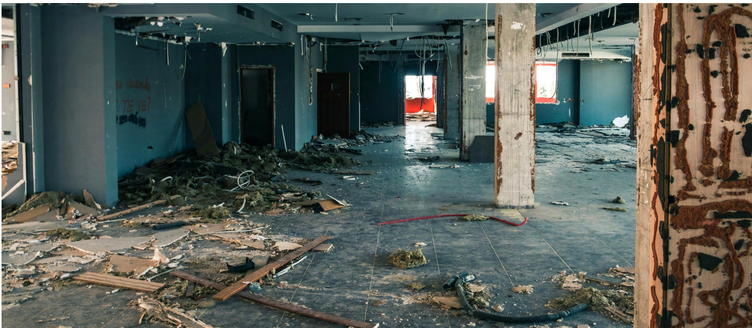
Danni da alluvione in stabilimento (foto Pexels).
