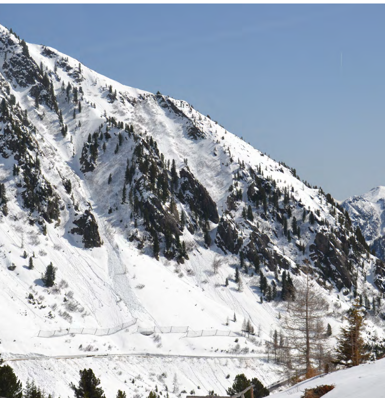
Pendio con paravalanghe a protezione della strada presso Passo Manghen (foto: Efisio Siddi).
